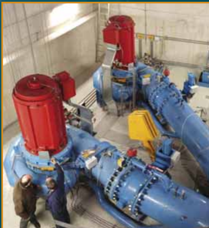
Centrale idroelettrica con due unità parallele
